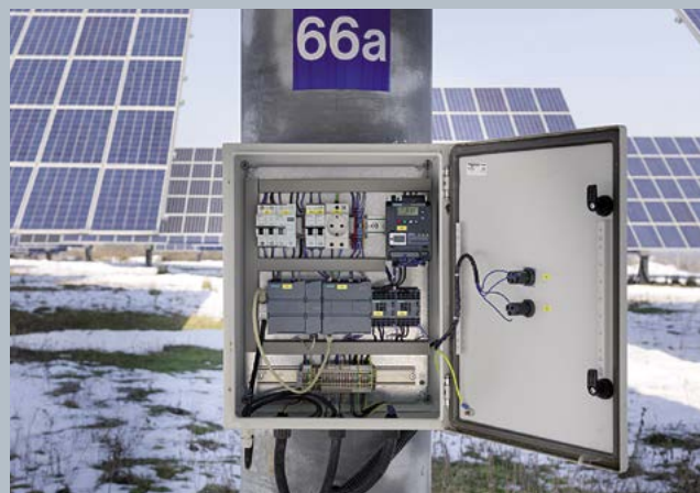
Schaltschrank am Mast
